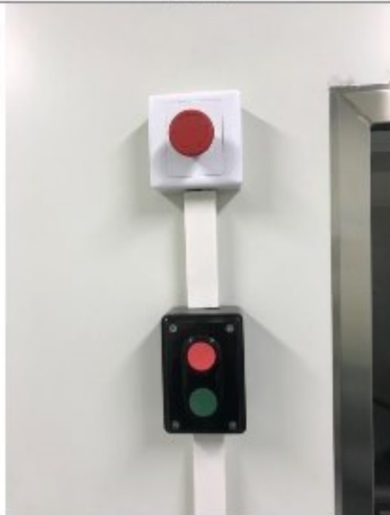
控制室急停按钮
